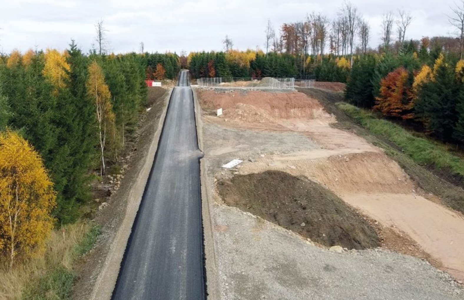
Maß- und Rücksichtslosigkeit: Aufschüttungen, Abgrabungen, Asphaltierung von Waldwegen im Reinhardswald
